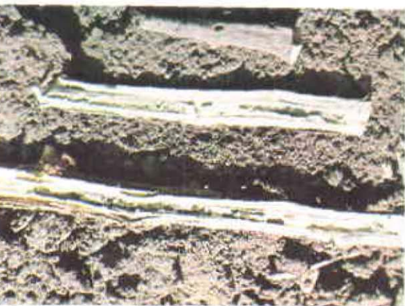
(c) Danos induzidos por cupins
