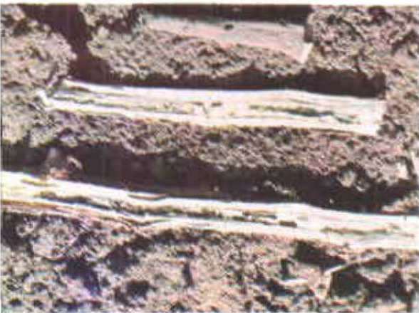
(c) Daño inducido por comejenes
