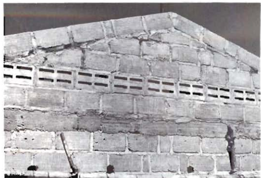
Figura 19. Para una ventilación adecuada de la bodega se deben colocar calados de cemento a lo largo de las paredes.
