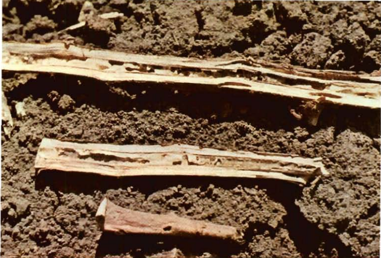
Dano às estacas causado por cupins
