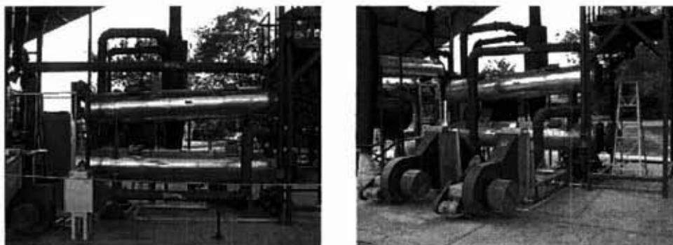
Figuras 6.3.6. Vista general del activador enzimático y del presecador, se muestra la ubicación de los ventiladores que suministran el aire caliente.
